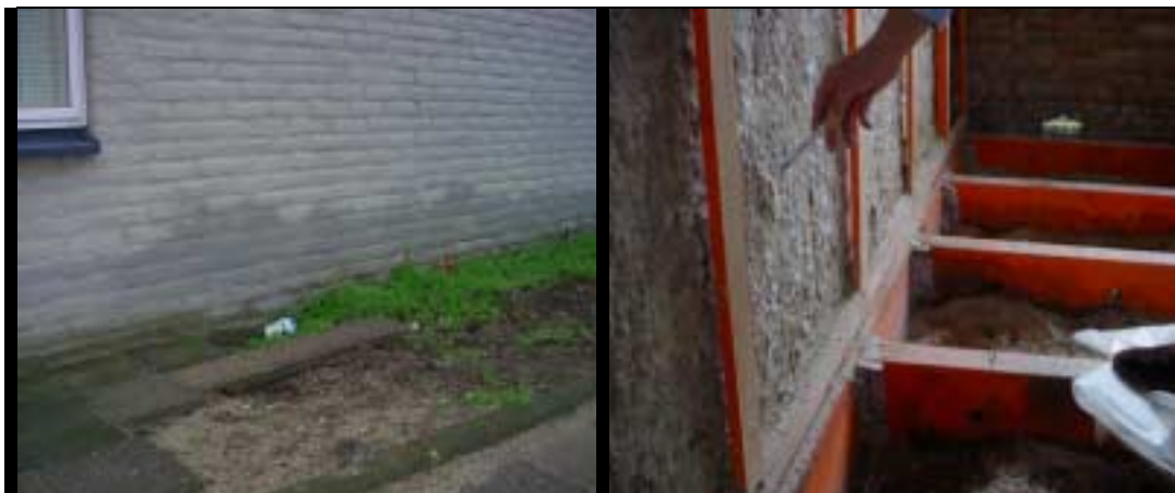
Figuur 3.1 Optrekkend vocht en beschimmelde muren
